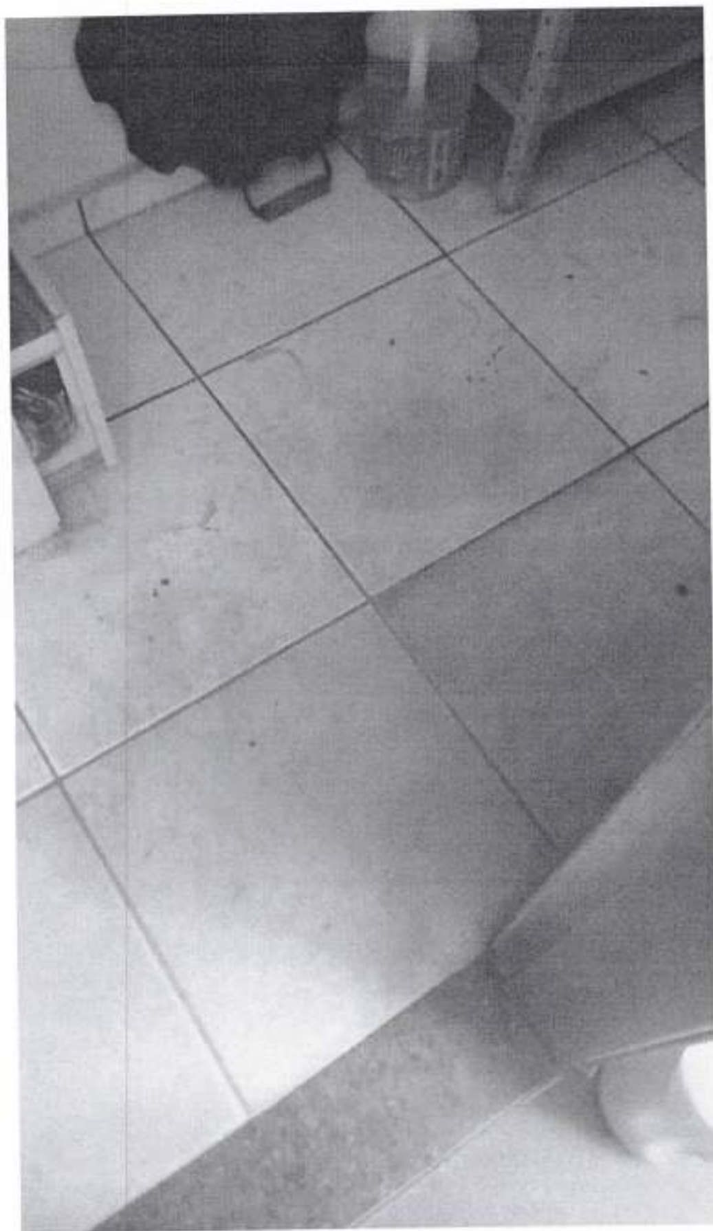
ECOBRAZIL – ECOL GESTÃO DE FACILITIES CNPJ/CPF: 32.708.178/0001-88 DEPARTAMENTO DE QUALIDADE E SUPERVISÃO OPERACIONAL – ocorrência n 002
