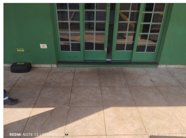
conforme, manchas do próprio piso
