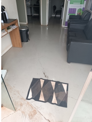
Manchas de desgaste
